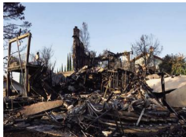
这是10月12日在美国加利福尼亚州波特兰奇拍摄的被烧毁的房屋。
